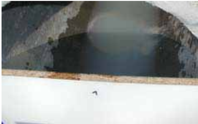
Bild 22: Schwefelsäure im Rohr
