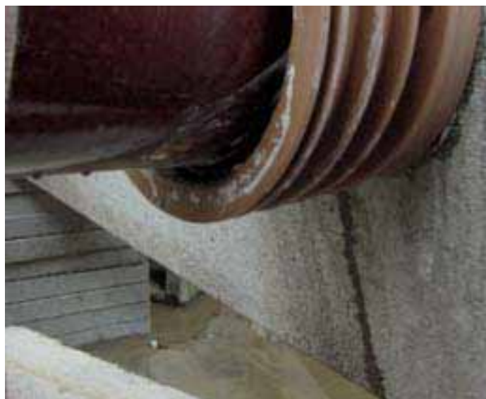
Bild 28: Wasseraustritt am Stutzen nach der Langzeitscherlast
