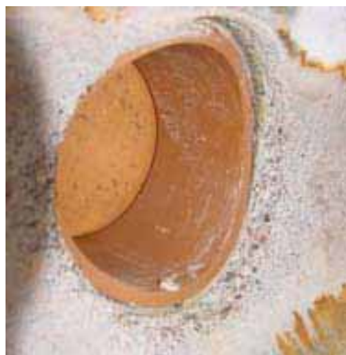
Bild 30: Anschlussbereich im Betonrohr nach Schwefelsäurebefüllung
