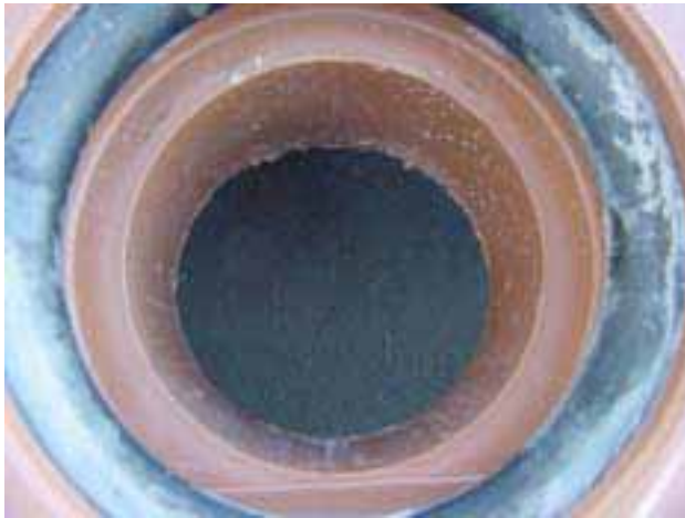
Bild 31: Schäden nach dem Einsatz der Kettenschleuder
